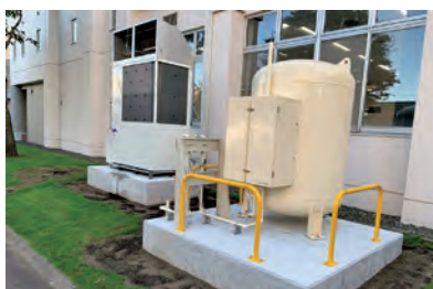
発電機能を持つガスバルクタンク
